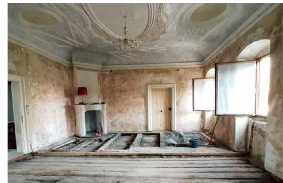
Ein Haus braucht Energie über den gesamten Lebenszyklus – auch bei der Sanierung
