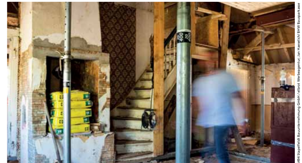
Keine Seltenheit bei der Altbauanierung – schadstoffbelastete Baumaterialien
